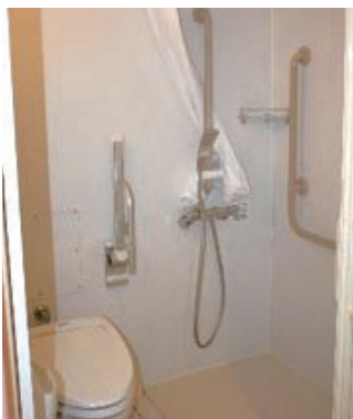
シャワーユニット
