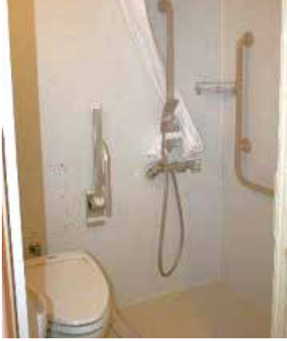
シャワーユニット
